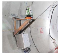
MTG-L 白龙港工程应用
