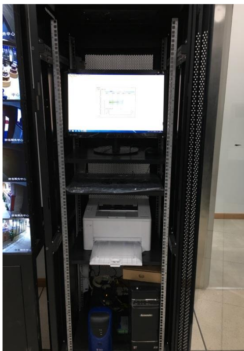
自动化监测机房
