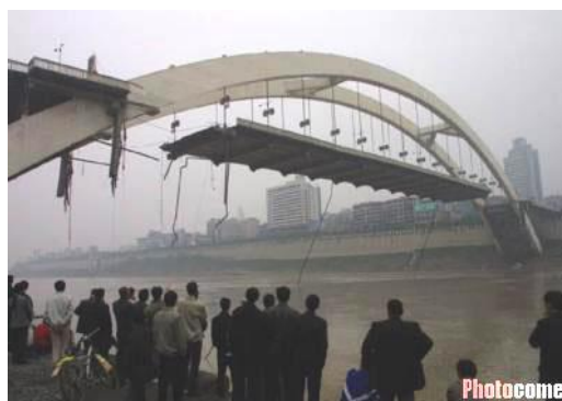
2001年，我国四川宜宾南门大桥吊杆断裂，部分桥面垮塌
