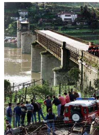
2001年，葡萄牙杜罗河公路桥坍塌，70余人落水失踪。
